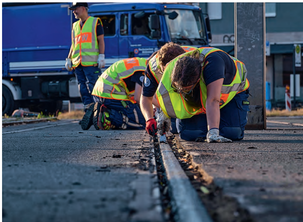
Mühsame Arbeit, um der Straßenbahn zu helfen. Wegen des aufgeweichten Bitumens konnte sie nicht mehr fahren.
