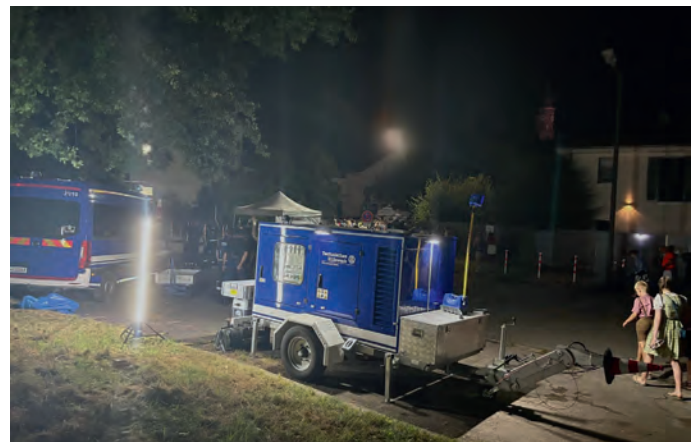
Mit einem schallgedämmten Aggregat sorgt der THW-Ortsverband Wörth für eine autarke Stromversorgung.
