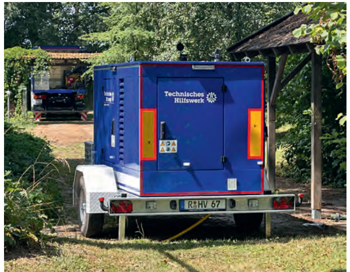
Die Stromerzeugungsanlage sorgt für den nötigen Strom zum Betrieb der Tauchpumpen.
