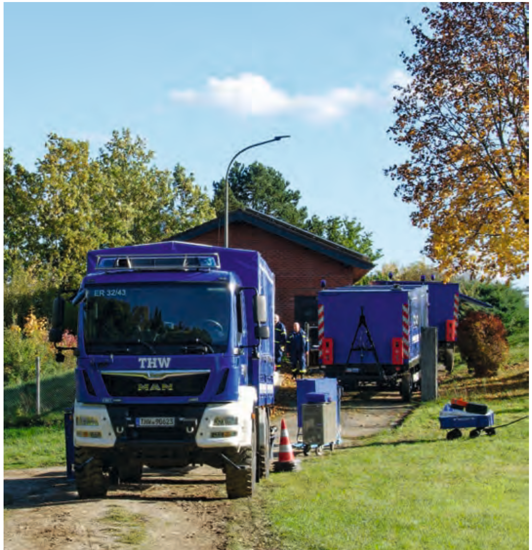
Beide 200-kVA-Netzersatzanlagen kommunizierten über CAN-Bus (Datenbus), um die angeforderte Leistung abzugeben. Foto: Bernhard Weißkopf
