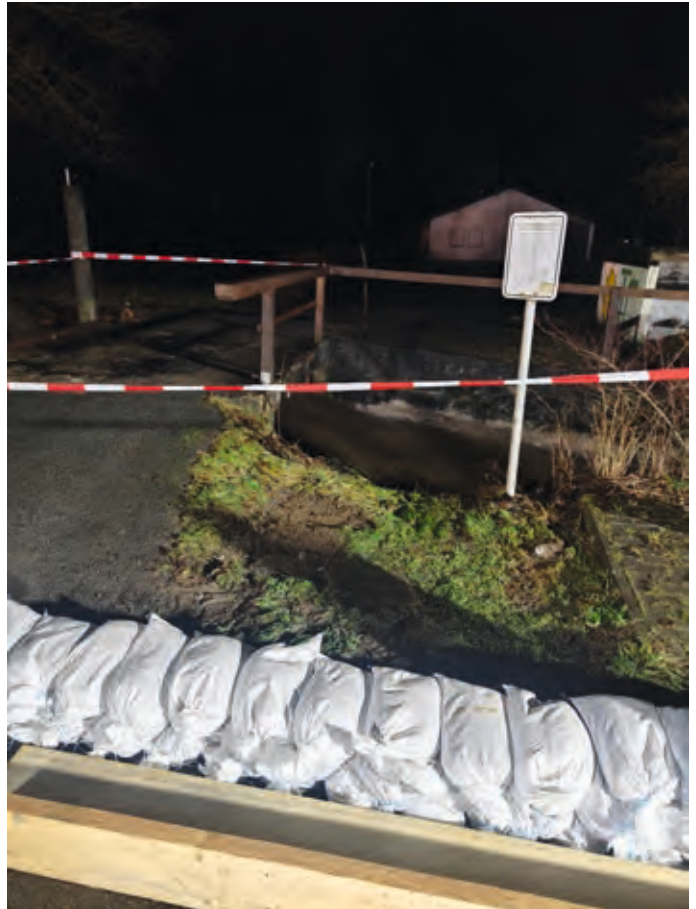
Wasser drohte ins anliegende Hotel zu laufen. Bagger konnte Abflussschackade lösen. Sandsäcke leiteten Wasser vom Hotel ab.
