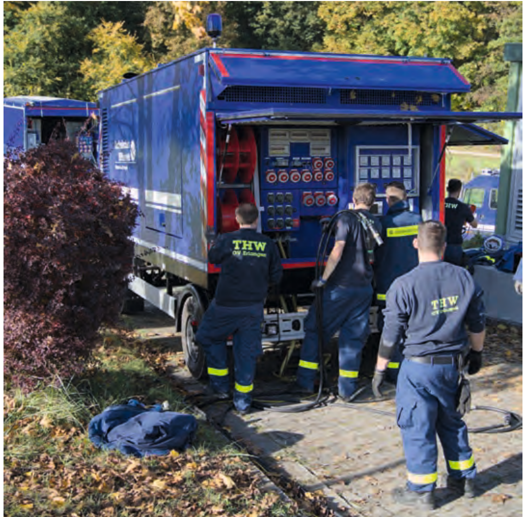
Aufbau und Verbindung der Netzersatzanlagen mittels CAN-Bus (Datenbus).
