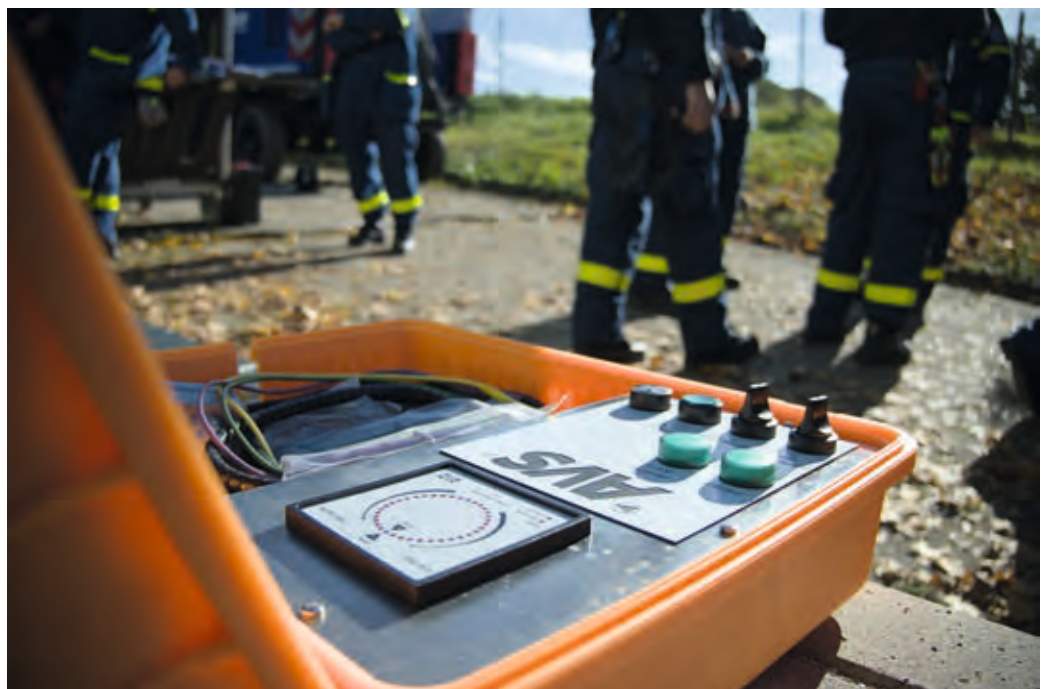
Durch den Einsatz der Rücksynchronisierereinrichtung können Netzersatzanlagen-versorgte Inselnetze unterbrechungsfrei wieder mit dem öffentlichen Stromnetz verbunden werden. Foto: Yannick Hillen
