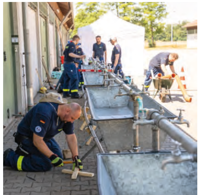
Herstellen der Wasserversorgung für das Feldlager, das Warmwasser wurde bei den Temperaturen zwar nicht unbedingt gebraucht, doch das Wasser an sich war für die eingesetzte FG Infrastruktur am Ende eine willkommene Abkühlung.
