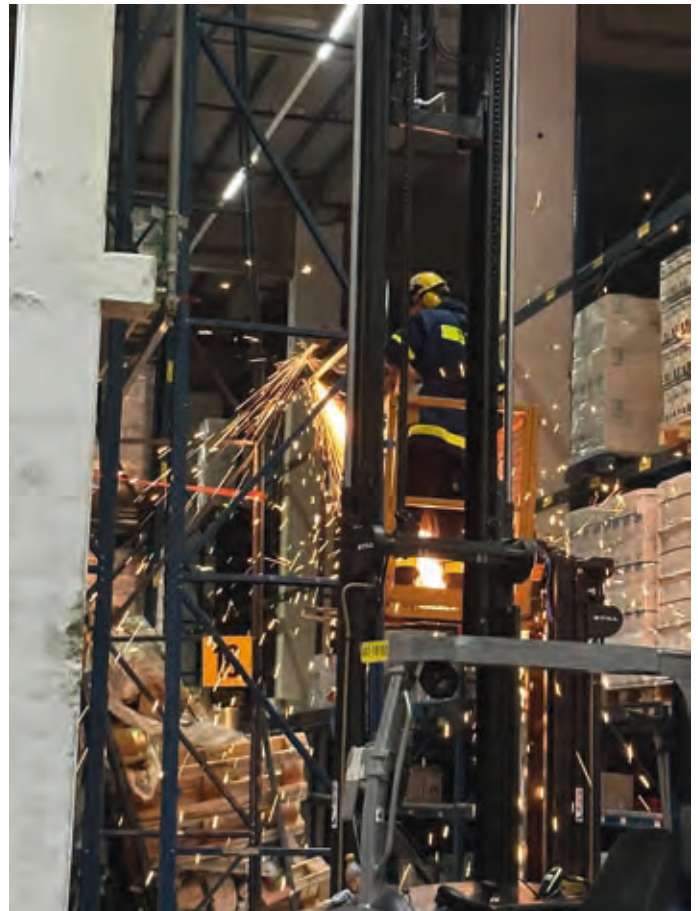
Das eingestürzte Hochregal wurde mit dem Trennschleifer zerlegt.
