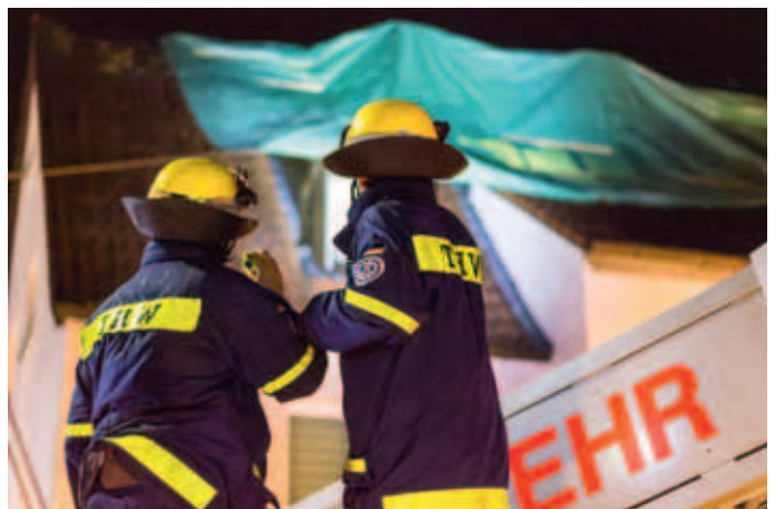
Ein Kamin sowie eine Satellitenschüssel bereiteten zeitweilig Probleme beim Aufziehen der Plane.
