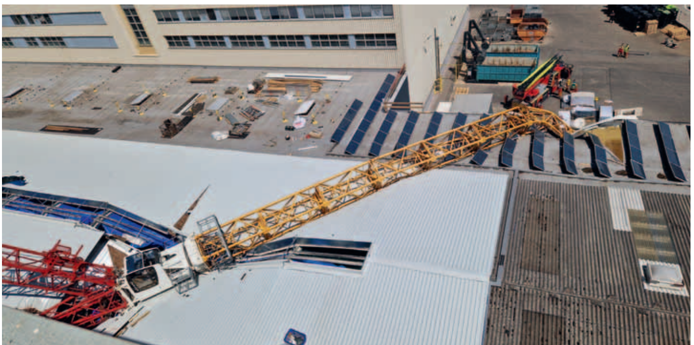
Blick auf den zerstörten Kran auf den Gebäuden von oben.
