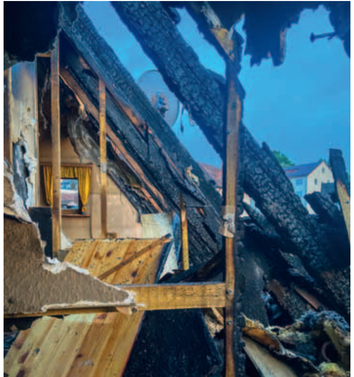
Ein Bild der Zerstörung zeigte sich nach dem Blitzschlag im Dachbereich des Mehrfamilienhauses.
