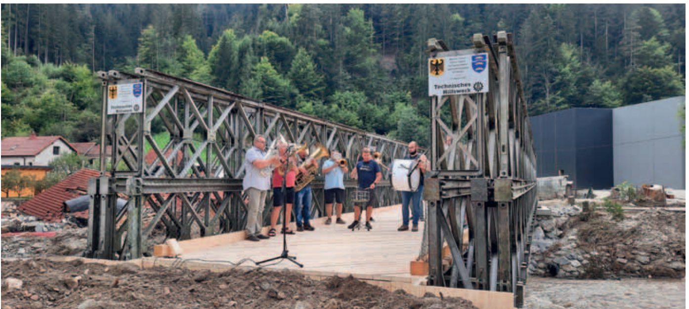
Eröffnung der zweiten Behelfsbrücke: Die Blaskapelle von Prevalje untermalt den festlichen Akt musikalisch. Bemerkenswert: Hier ist die Anbindung an die Straße bereits fast fertig. Und das in wenigen Stunden.
