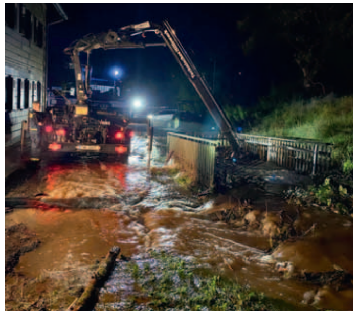
Der verstopfte Bacheinlauf musste von Schlamm und Treibgut befreit werden. (oben)
