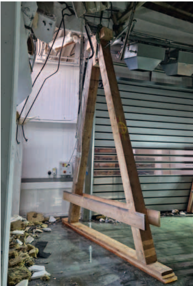
Ein angeschlagener Betonträger wurde durch eine Holzabstützung gesichert. Diese Konstruktion in Form eines A wurde durch ehrenamtliche Freisinger Einsatzkräfte des THW aufgebaut und leitet die Kräfte nun sicher nach unten ab.
