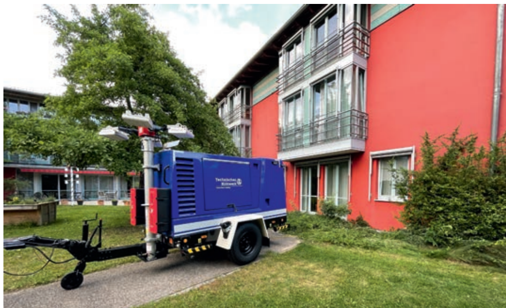
Einspeisung Alten- und Pflegeheim mit NEA 50 k A der FAGr. N OV Freising
