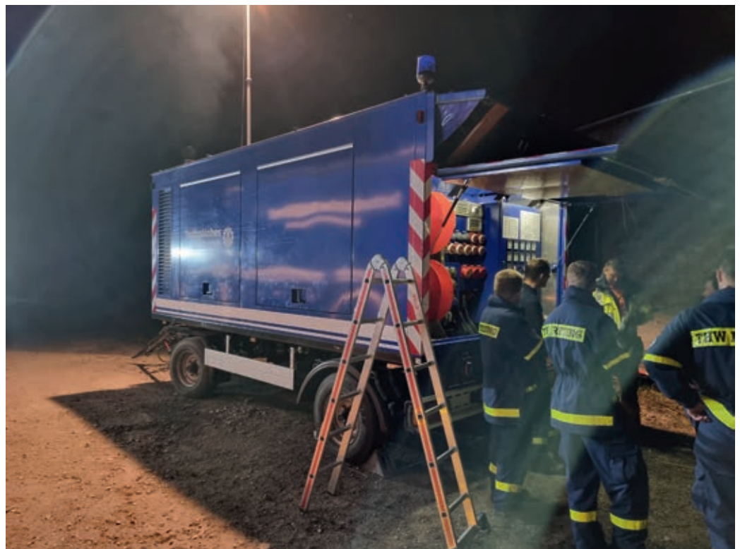
Einspeisen in eine Unterverteilung durch das NEA 200 kVA vom OV München-Mitte im Gemeindegebiet Wang
