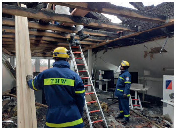
Das ausgebrannte und beschädigte Dach wurde unter anderem mit Baustützen und Dachbalken gesichert. Außerdem wurde entschieden, ein Notdach zu montieren.
