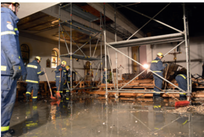
Aufräumen: Um den Brandermittlern einen sicheren Zugang zum Kirchenschiff zu ermöglichen, räumte das THW Eichstätt unter mobilen Schutzgerüsten Schutt aus der Kirche.
