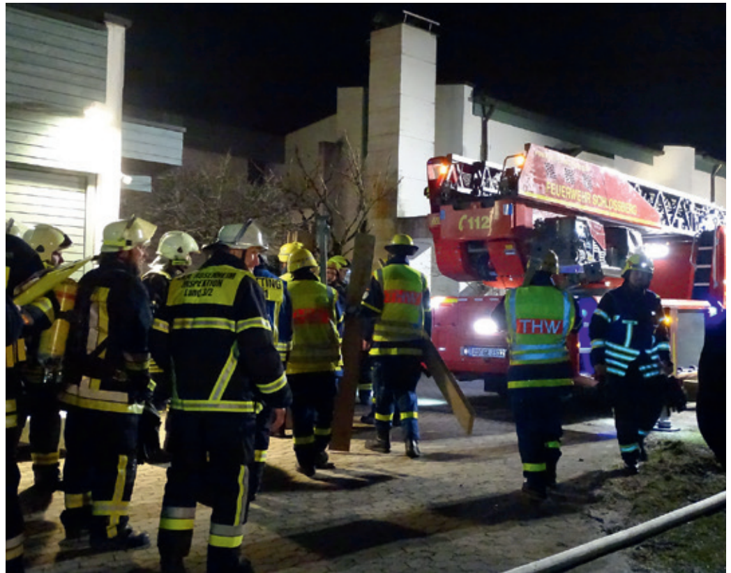
Helfer des OV Rosenheim mussten erst die Einsturzgefährdete Kellerdecke absichern, bevor die Kameraden der Feuerwehr das Gebäude betreten durften.
