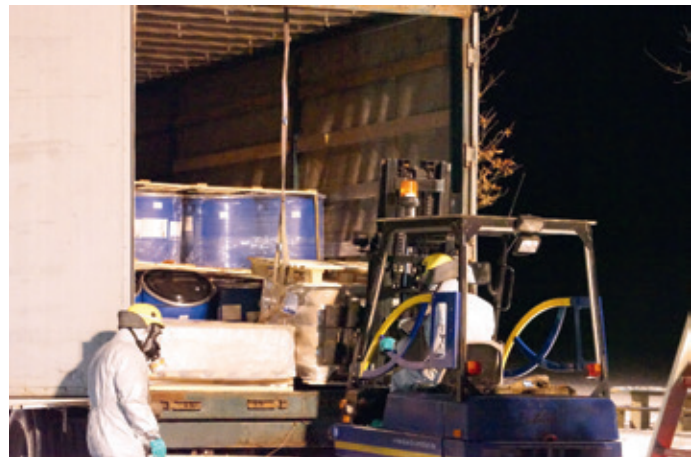
Mit dem Gabelstapler wurde der LKW-Auflieger vorsichtig entladen, um das Ausmaß der Beschädigung der Fässer begutachten zu können.
